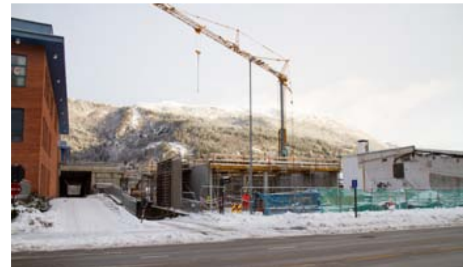
KRANA PÅ Plass: Her blir det nye Nynorskhuset bygd midt i Førde mellom handelshus og rutebilstasjon. FOTO: IVAR BRUVIK SÆTRE
